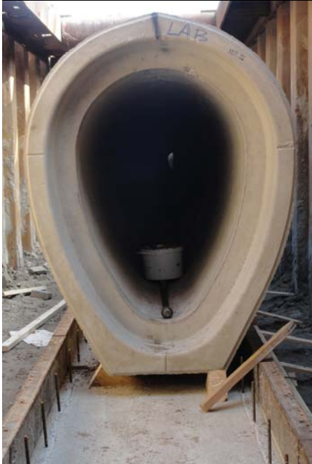
Betonnen rioolbuis op betonnen funderingsbalk
